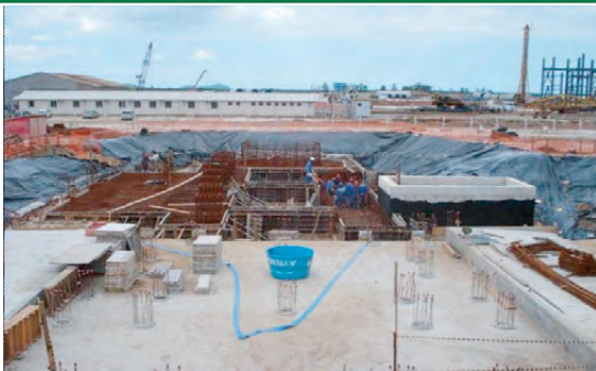
Vista da base da caldeira
