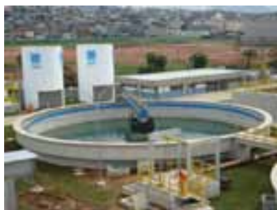
Decantador secundário da ETE São João
