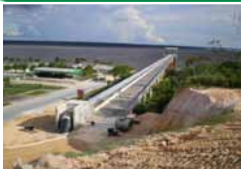
Unidade de captação de água bruta no Rio Negro
