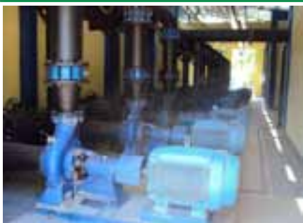
Estação elevatória de água tratada 04 – EAT 04
