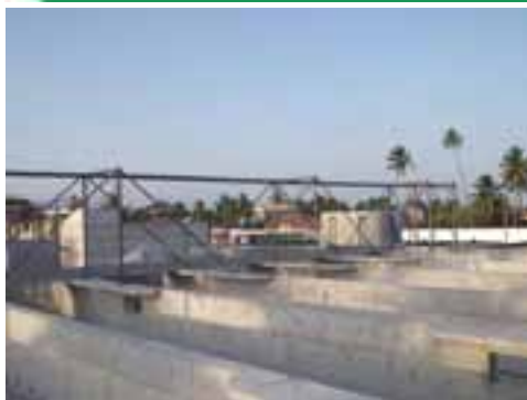
Reator da ETE de Barra dos Coqueiros
