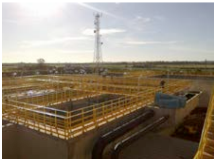
ETE – Sarandi - Reatores
