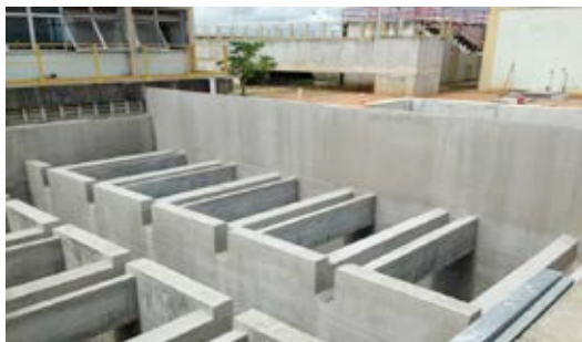
Estação de tratamento de água
