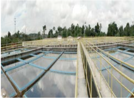
Decantadores da estação de tratamento de água
