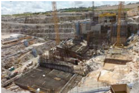
Vista geral do circuito de geração
