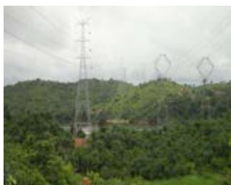
Interligação Tucuruí-Macapá-Manaus Lotes A e B
