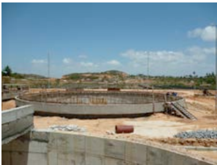
Decantadores ETE ERQ Sul
