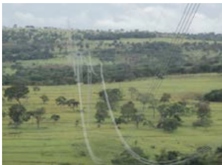
Interligação Madeira-Porto Velho-Araraquara – Circuito 1
