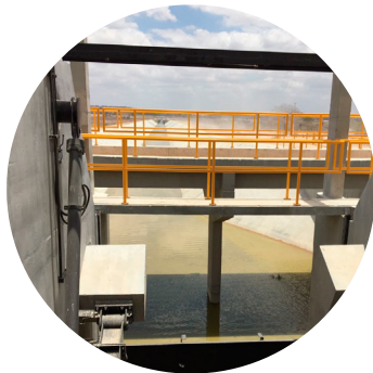
Canal do Sertão Alagoano Sistema de comportas concluído
