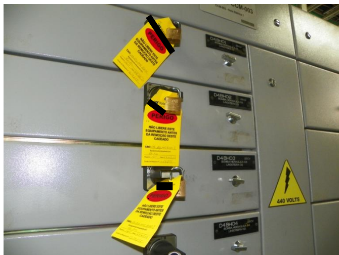
Figura 66 - Quadro elétrico de máquina com bloqueio (cadeado) e sinalização (etiquetas).
