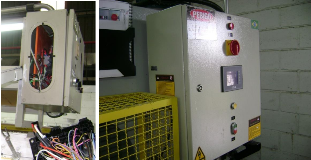
Figura 41 - Quadro elétrico aberto (esquerda) e Quadro elétrico fechado (direita)
