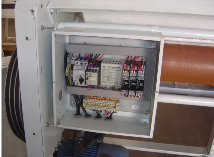
Figura 43 - Quadro elétrico em cilindro de panificação.
