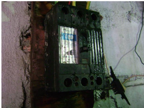
Figura 40 - Instalação elétrica com presença de umidade.
