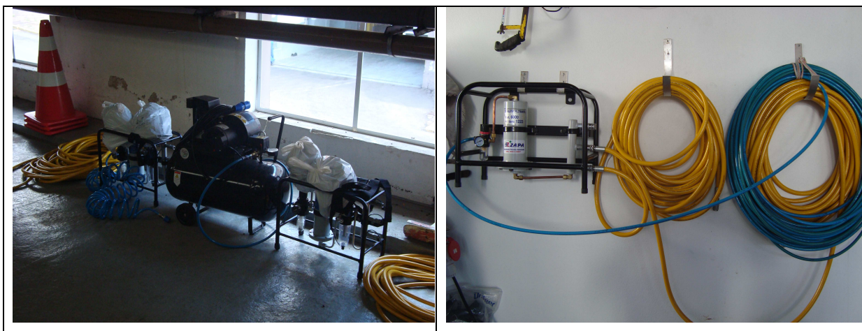
Figuras 19 e 20 – Equipamentos para entrada em espaços confinados com atmosfera Imediatamente Perigosa à Vida e à Saúde – IPVS – adquiridos pelas empresas notificadas
